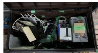
図3 装置ボックス内部
